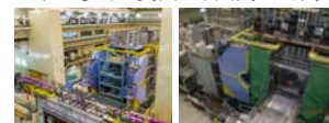
巨大測定器 Belle II 改造工事前(左)、改造工事中:見学時(右)
